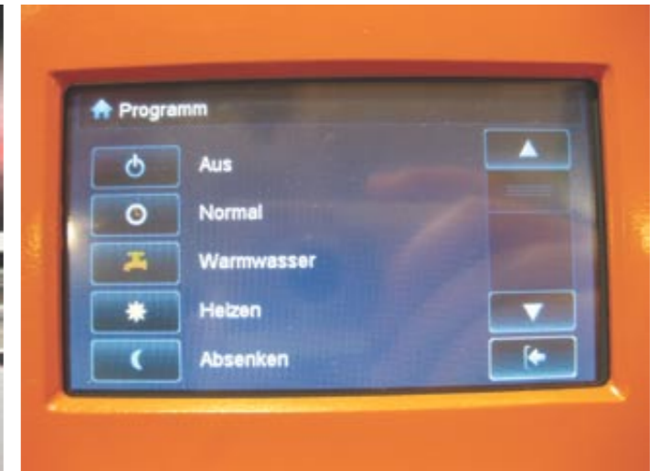
Čelní pohled na displej automatického kotle BIOSMART.
