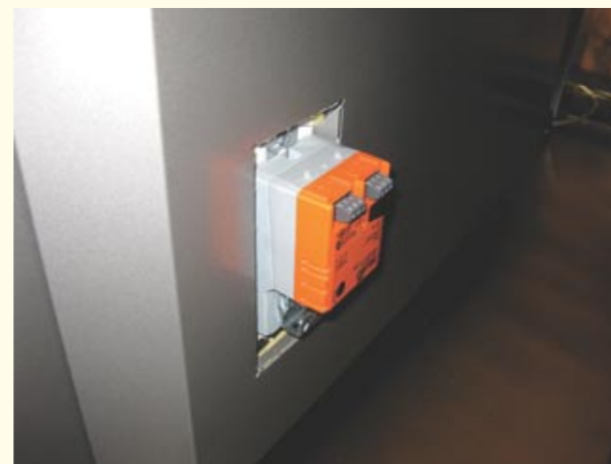
• Pohled na servopohon, který reguluje množství primárního a sekundárního vzduchu v jednotlivých částech kotle.
