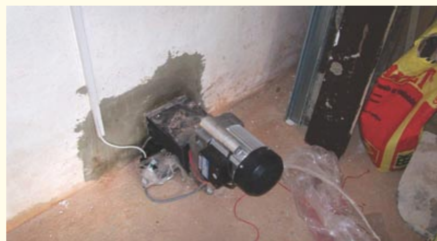
Pohled na hnací ústrojí šnekového dopravníku sezónního skladu paliva, které je umístěno mimo sklad.
