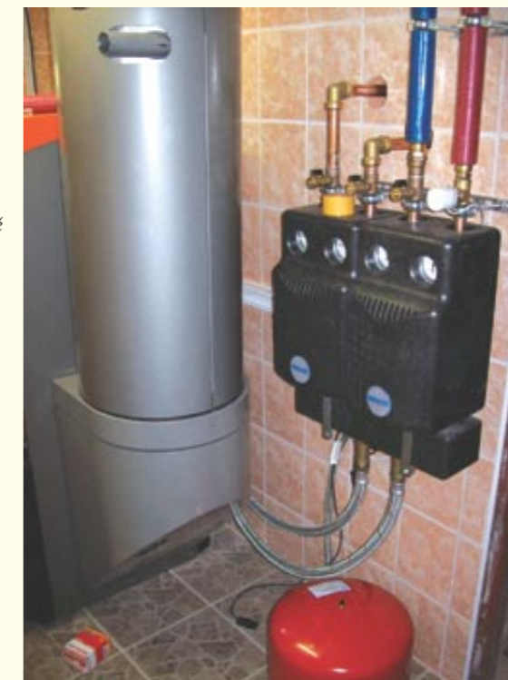
Pohled na strojovnu kotle Guntamatic.
