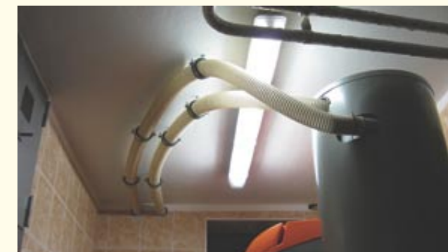
Detail vedení a vstupu plnicích hadic do mezizásobníku kotle.
